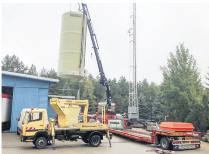
Modernisierte Solelöseanlage in der Straßenmeisterei Hoyerswerda: Zur Verbesserung der Feuchttausalz-Qualität wurde in der Straßenmeisterei Hoyerswerda die alte Solelöseanlage modernisiert. Die Anlage verfügt über eine Lösekapazität von 2.600 l/h und eine Lagerkapazität von 80 m 3 . Zur Soleherstellung wird das eingelagerte Tausalz verwendet.
