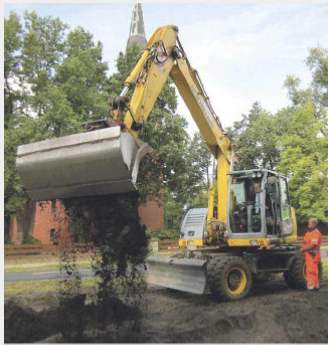
Staatsminister Morlok ließ es sich nicht nehmen, selbst den ersten Baggeraushub für das Bauvorhaben vorzunehmen.
