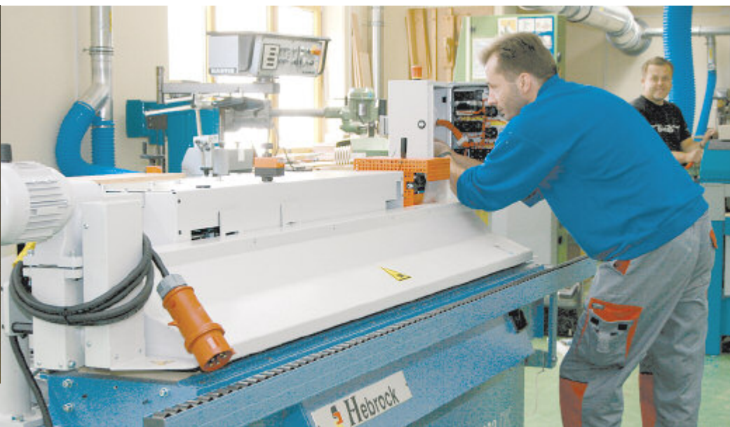
Thomas Janke und Andreas Kruschka von der Mickel-Elektro GmbH führen die notwendigen Elektroinstallationen an der Kantenleimmaschine aus.
