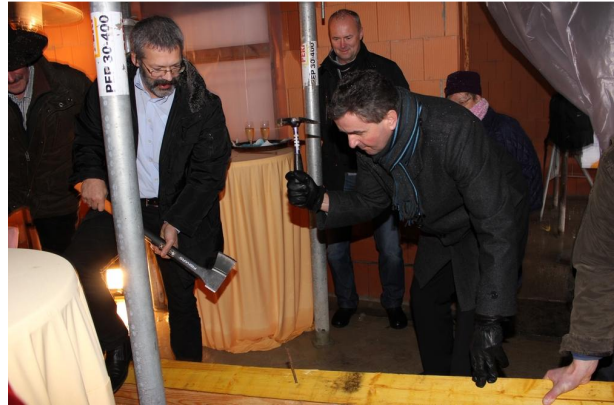
Bürgermeister Hellfried Ruhland und der Amtsleiter des Gebäude- und Liegenschaftsamtes Valentin Opitz sorgten beim Einschlagen des letzten Nagels dafür, dass beim Richtfest in Lauta alles seine Richtigkeit hatte.
